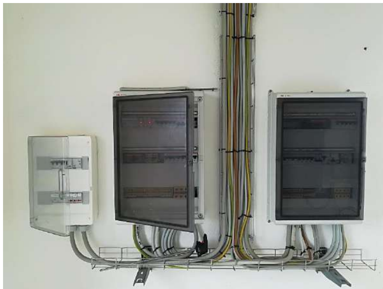
Fig. 2.3: Quadro elettrico di campo
