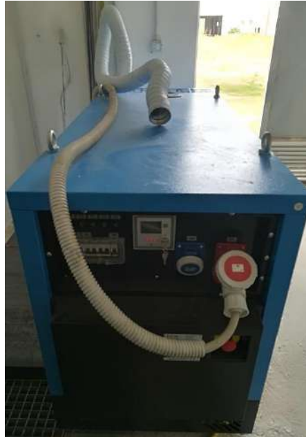
Fig. 2.8: Gruppo elettrogeno da 11 kVA
