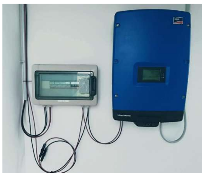
Fig. 2.2: Inverter SMA da 9 kW
