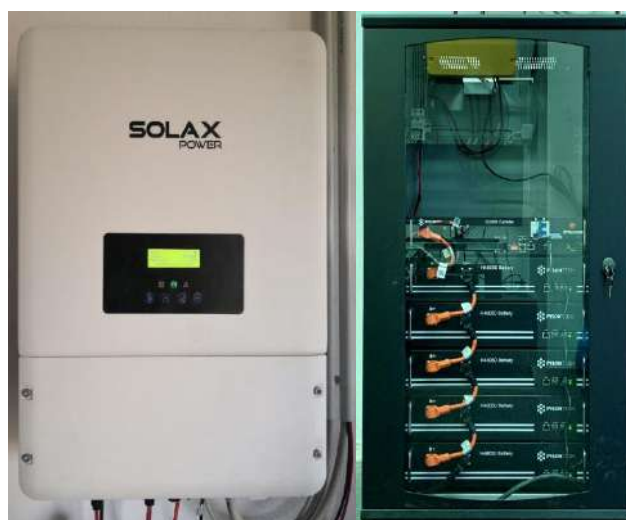
Fig. 2.4: Sistema di accumulo
